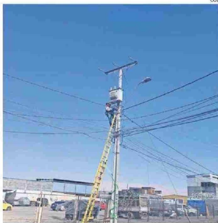
SECTOR ENFRENTA PROBLEMAS POR CONEXIONES IRREGULARES.
