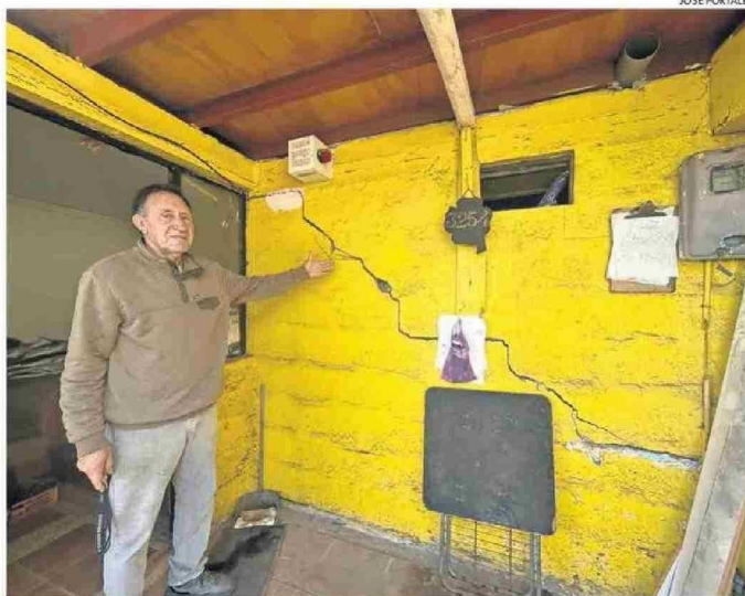
LOS DAÑOS ESTRUCTURALES COMENZARON EN 2017, DURANTE LAS OBRAS DEL SEGUNDO ACCESO.
