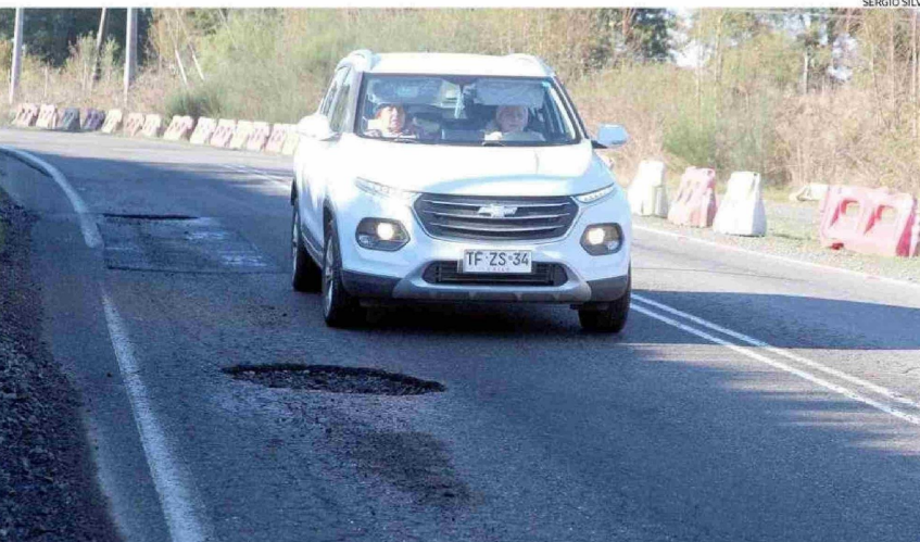
HAY DOS HOYOS SEGUIDOS, DE GRAN TAMAÑO, EN EL INGRESO DE ORIENTE A PONIENTE AL PUENTE MECANO, EN UNA ZONA DE CURVA.
