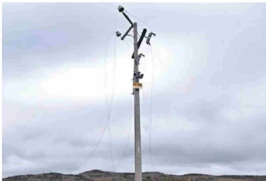
Continúa sin solución el delito del robo de cables en la región. EL OVALLINO
