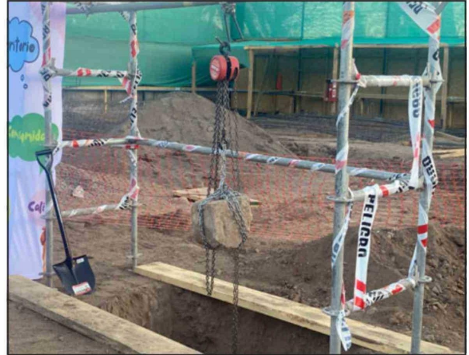
Tragedia enluta obras del nuevo Cesfam de Curimón (Imagen de archivo).
