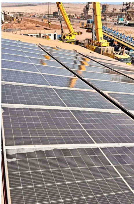
La planta ha operado de forma eficiente y estable, cubriendo una parte significativa del consumo energético del Service Center.
