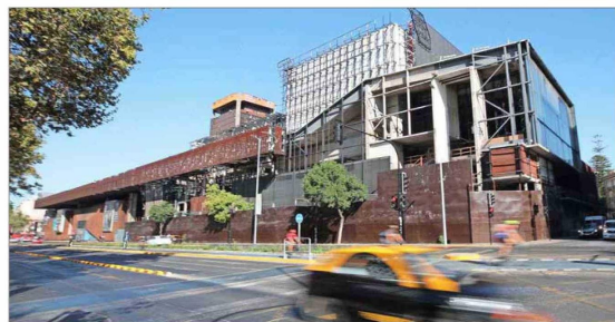
Así luce la gran sala del GAM. En 2018, la constructora quebró y no se continuó con la obra.
