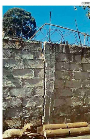
MUROS PERIMETRALES DE VECINOS HAN SIDO AFECTADOS.
