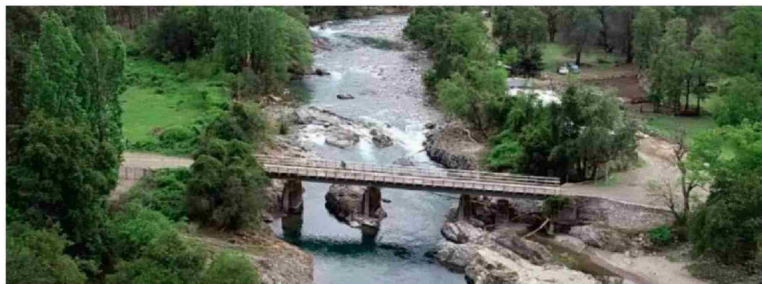
DESDE LA DIRECCIÓN DE VIALIDAD aseguran que la estructura actual podría suponer un riesgo en caso de crecidas centenarias.
