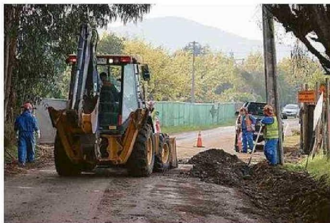
EL DERRAME OCURRIÓ EN UN PREDIO COLINDANTE A LA RUTA F-232.
