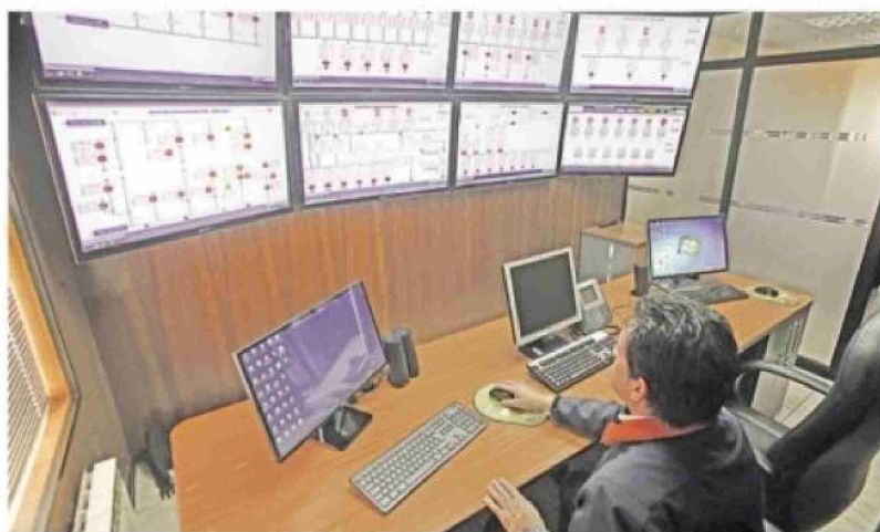
La automatizada planta Tres Puentes de la Empresa Eléctrica de Magallanes.
