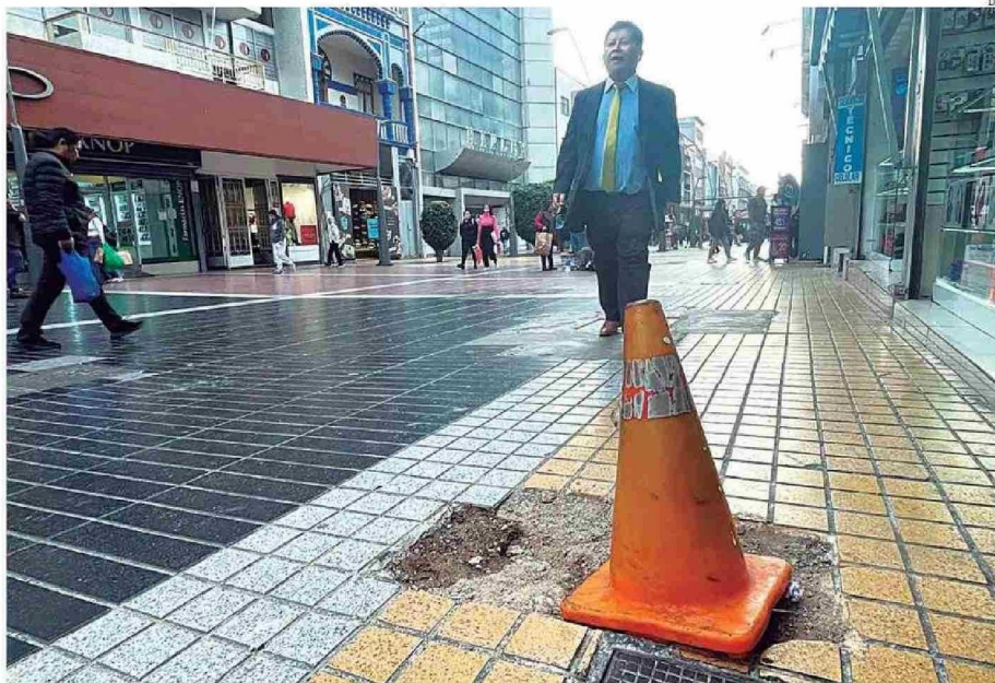
EL DESPRENDIMIENTO DE BALDOSAS AFECTA A VARIOS TRAMOS DEL PASEO PRAT.
