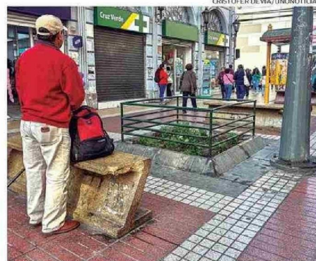
LOS ESCASOS ASIENTOS PRESENTAN UN EVIDENTE DETERIORO.
