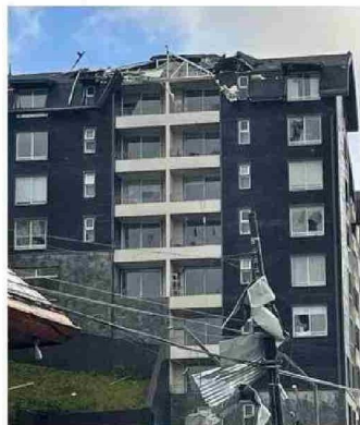
EDIFICIOS Y VEHÍCULOS FUERON DAÑADOS.
