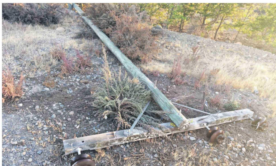
Cortes eléctricos prolongados han generado pérdidas en hogares rurales y afectado el funcionamiento de sistemas de agua potable en la provincia.
