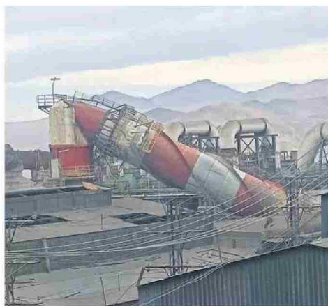
LA CAÍDA DE LA ESTRUCTURA OCURRIDA EN JUNIO.
