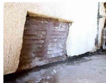
Las filtraciones por las paredes son muy evidentes en el complejo habitacional Villa Rodolfo Cortés.
