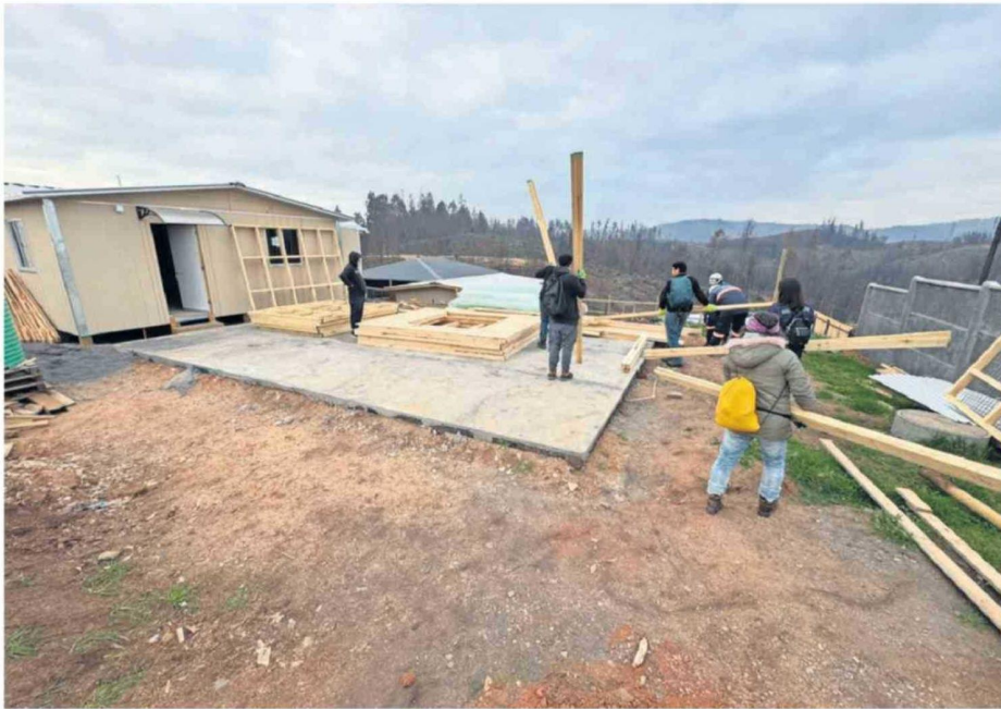
El proceso de instalación se concretó con apoyo de voluntarios y de la Defensa Civil.
