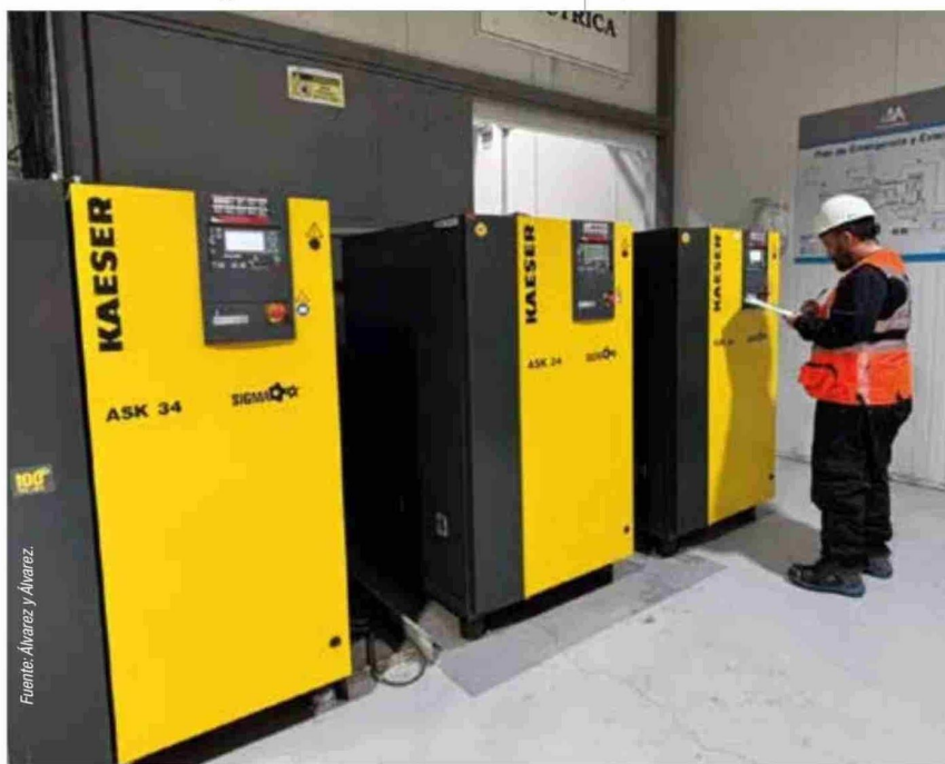
Control energético planta de proceso.
