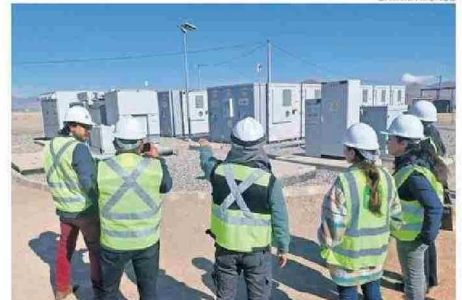
EL ALMACENAMIENTO ACTUAL CONSISTE EN 24 CONTAINERS DE BATERÍAS
