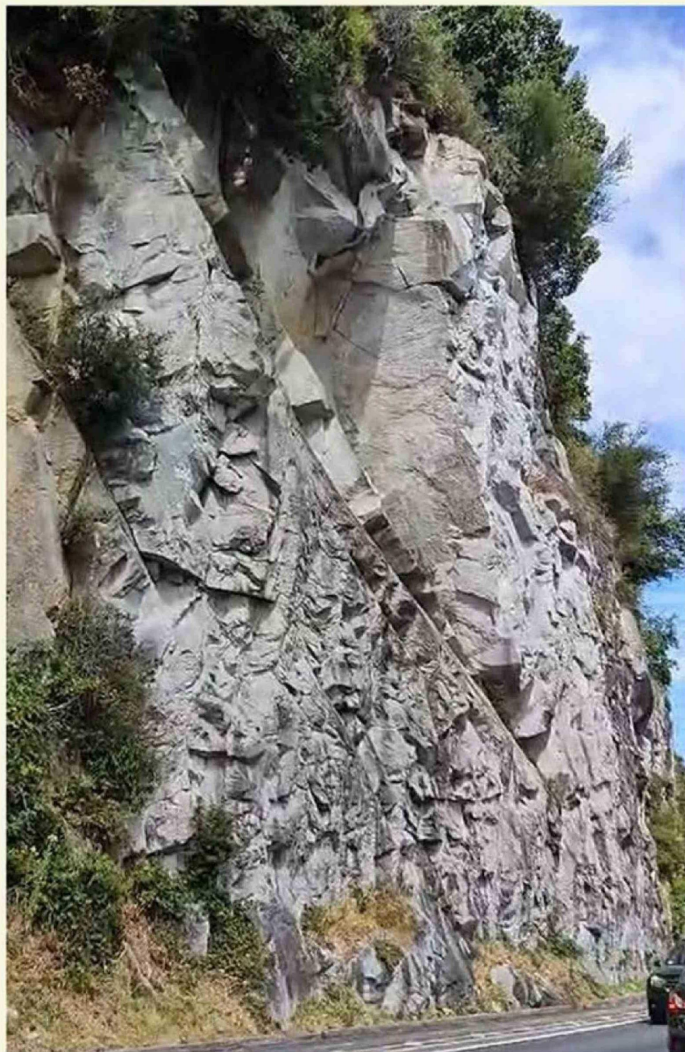
La situación fue detectada en el sector La Cantera, comuna de Puerto Varas, donde se observa una fractura de consideración en una pared rocosa ubicada a un costado de la vía.
