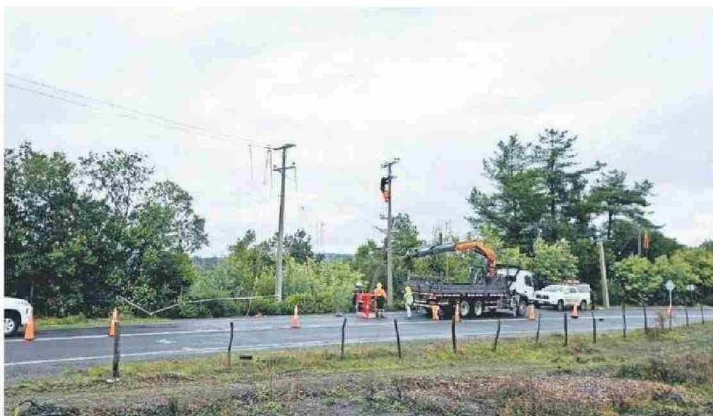
La SEC se ha desplegado en terreno para monitorear las labores de recuperación del servicio.
