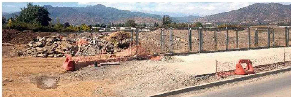
Denuncia por acopio de escombros en Machalí activa fiscalización de SERVIU.
