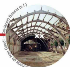
EL DETERIORO Y OLVIDO
