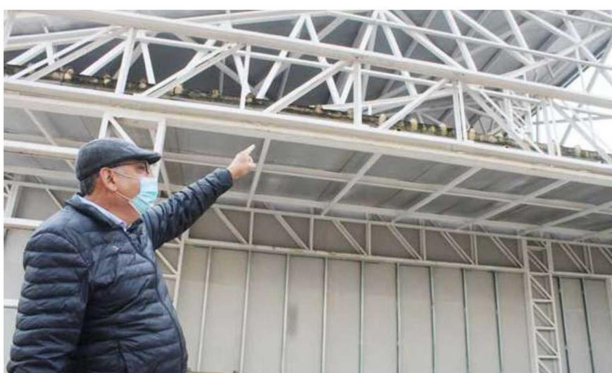
Parte de la estructura de la parroquia Santa Gemita que nos muestra el padre Ángel Fuentes que, para el bien de la comunidad, necesita ser terminada.
