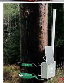
Sensores térmicos también permiten la detección temprana del fuego.
