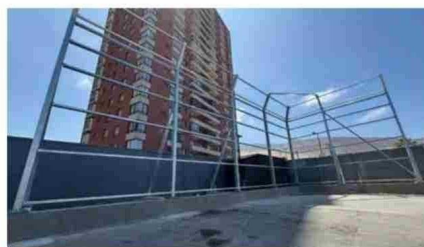
Estructura metálica modular de una barrera acústica.
