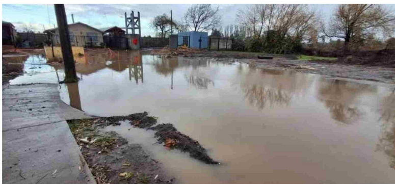
ACUMULACIÓN DE AGUAS LLUVIAS en la planta elevadora nunca había sido tan grave como en los últimos meses.
