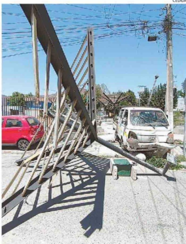
EL CAMIÓN IMPACTÓ AL TRABAJADOR Y ADEMÁS DE ARRASÓ CON LUMINARIAS DEL SECTOR.
