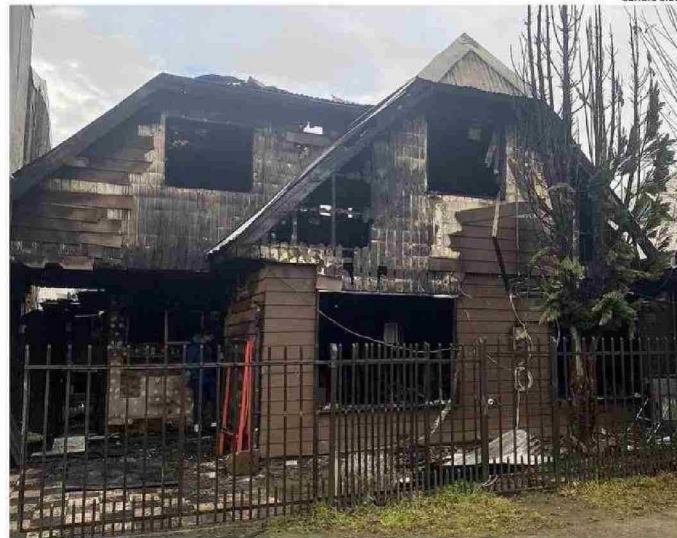
LOS DAÑOS SON TOTALES EN LA VIVIENDA QUE PERTENECE A UN MATRIMONIO Y QUE ERA ARRENDADA POR JÓVENES.
