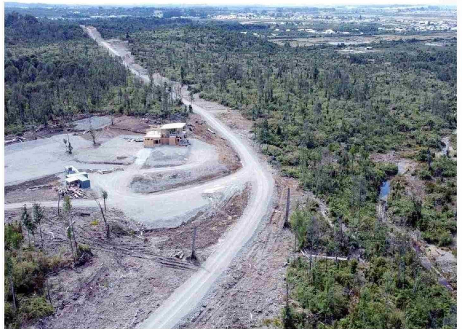
EN EL MUNICIPIO DIJERON QUE HAN FISCALIZADO Y PARALIZADO EN VARIAS OCASIONES ESOS TRABAJOS, AL NO TENER PERMISOS DE EDIFICACIÓN.
