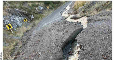
El mal estado de los caminos evidencia la precariedad de la infraestructura en las zonas más aisladas del país.
