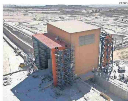
EL CHANCADOR DE DMH, MINA UBICADA A 10 KILOMETROS DE CALAMA.
