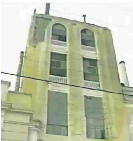
FACHADA DAÑADA DEL VIEJO EDIFICIO DE LAS CERVECERÍAS UNIDAS. AÑOS DESPUÉS FUE DEMOLIDA.
