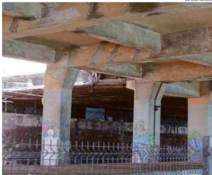
ASÍ SE ENCUENTRA LA BASE DE LA ESTRUCTURA ANTIGUA DEL PUENTE CAPUCHINOS.
