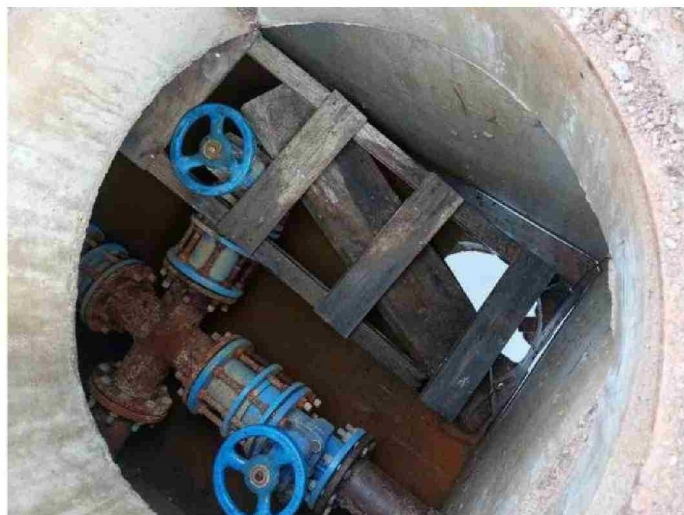
HACE AÑOS QUE LAS INSTALACIONES ESTÁN EN MAL ESTADO Y SIGUEN DETERIORÁNDOSE.
