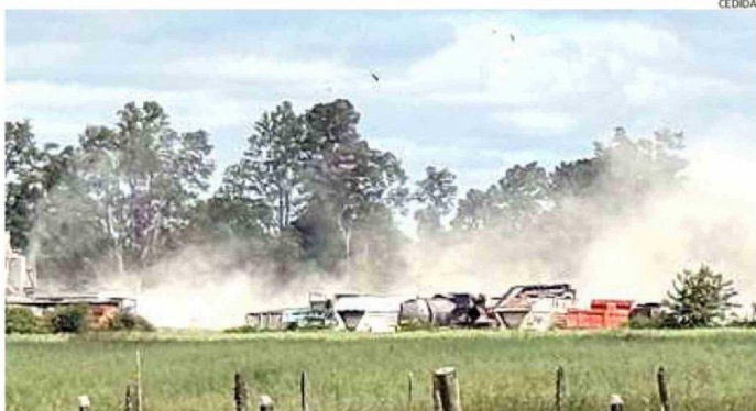
LA PLANTA DE CORRAL DEL SUR PROCESA ÁRIDOS, LO QUE GENERA UNA GRAN CANTIDAD DE POLVO.
