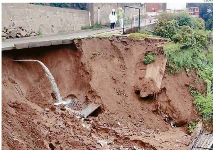
SOCAVÓN PERSISTE DESDE 2025 Y NUEVAS FILTRACIONES ESTE AÑO DAÑARON LA VÍA.
