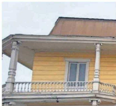
LOS BALCONES Y LA ESTRUCTURA PRESENTAN DETERIORO.
