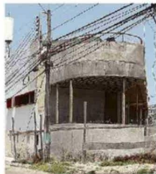
OBRAS ESTÁN PARALIZADAS.
