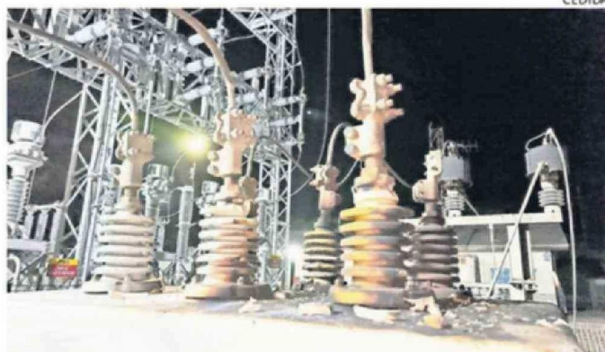
SUBESTACIÓN PERALES, EN LA COMUNA DE TALCAHUANO.
