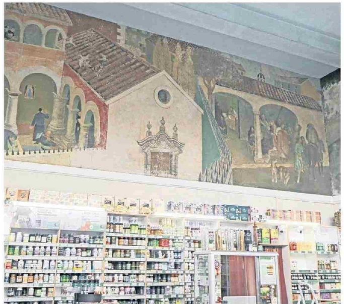
El mural data en la ex Maluje desde 1957, y el paso del tiempo ha provocado daños.
