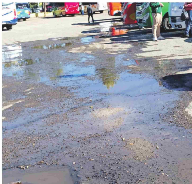
Aguas servidas emergen desde una cámara de alcantarillado en el terminal de buses rurales de la Feria Modelo, generando malos olores y condiciones insalubres para trabajadores y usuarios del recinto.
