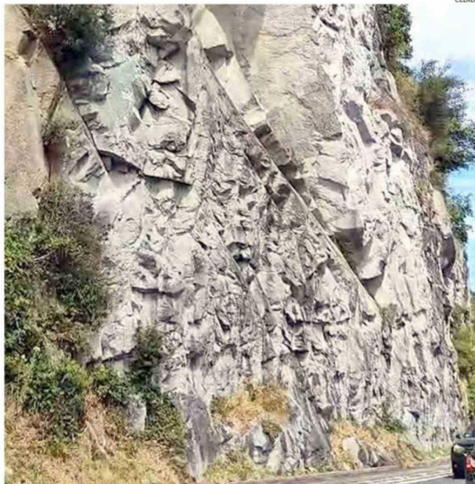
LA DEFORMACIÓN DE LA ROCA EN EL SECTOR LA CANTERA OBLIGA A LA DIRECCIÓN DE VIALIDAD A DESPLEGAR ESTUDIOS TÉCNICOS ESPECIALIZADOS. OBJETIVO ES EVITAR TRAGEDIAS EN UNA RUTA ALTAMENTE TRANSITADA.
