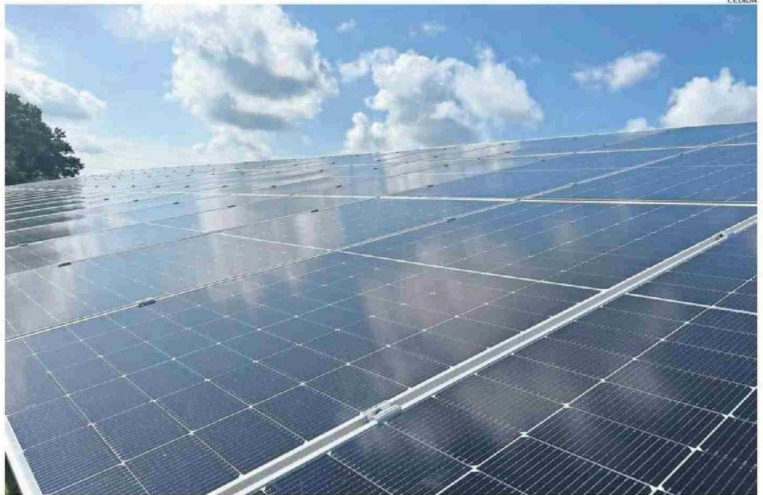
LOS DURMIENTES SE TRATA DEL PRIMER PROYECTO DE RWE APROBADO AMBIENTALMENTE EN CHILE.
