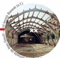
EL DETERIORO Y OLVIDO
