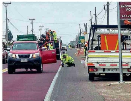
MÁS DE 40 CAMINOS DE LA PROVINCIA ESTÁN CONSIDERADOS.
