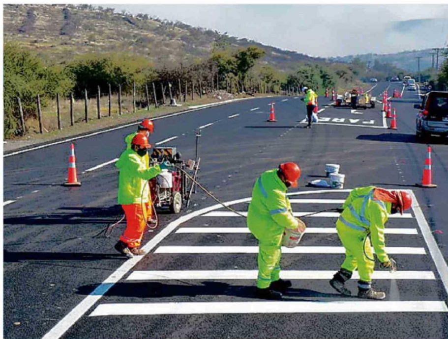
TRABAJOS DE MANTENCIÓN VIAL BUSCAN MEJORAR EL TRÁNSITO EN RUTAS DE LA PROVINCIA DE SAN ANTONIO.
