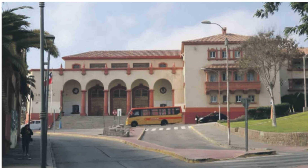
Filtraciones, daños estructurales y espacios clausurados forman parte de las problemáticas denunciadas en el Liceo Gabriela Mistral, situaciones que, por cierto, se repiten en buena parte de las escuelas y liceos públicos de La Serena.
