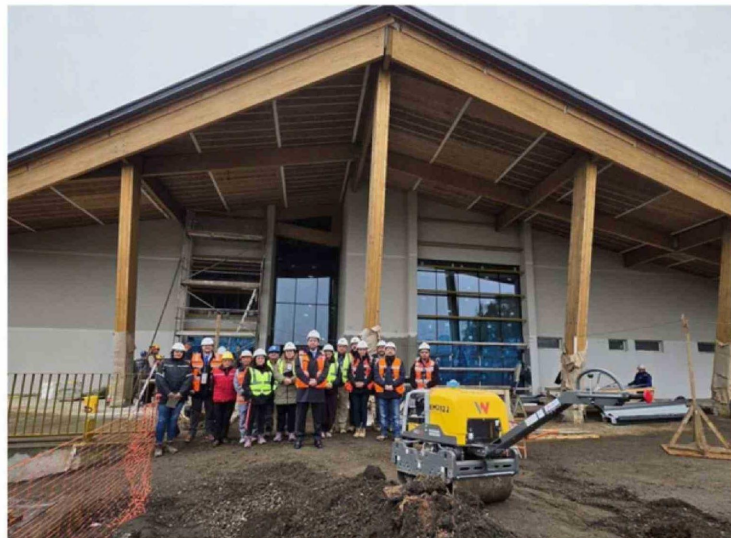
EL RECINTO PRESENTA UN ALTO GRADO DE AVANCE QUE FUE CONSTATADO POR LAS AUTORIDADES DE OBRAS PÚBLICAS.
