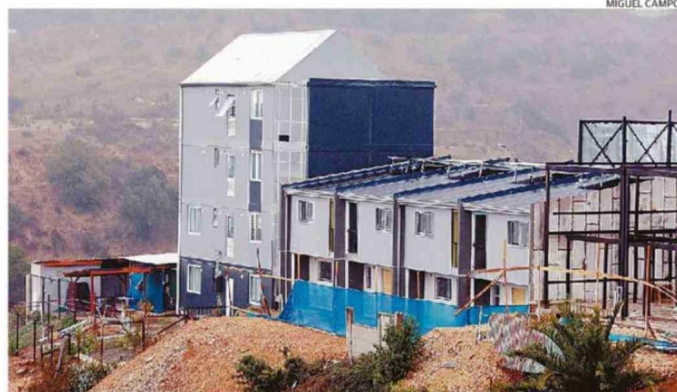
SERVIU DE VALPARAÍSO INFORMÓ QUE LAS VIVIENDAS ESTÁN EN PROCESO DE "REDISEÑO" ESTRUCTURAL.
