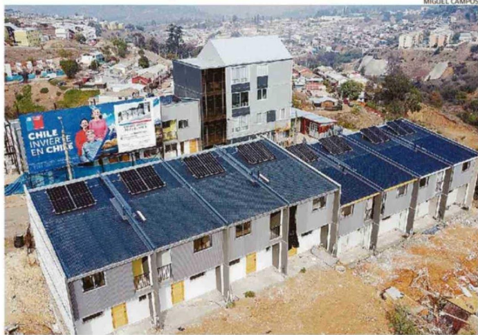
EN LA CALLE CHUSMIZA SE CONCENTRAN GRAN PARTE DE LAS VIVIENDAS A DEMOLER, CON MÁS DE UN 90% DE AVANCE.
